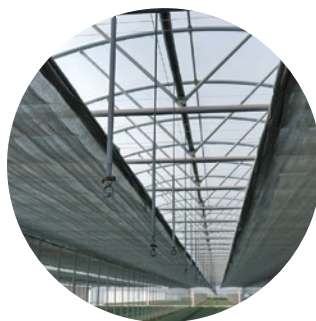
Teli ombreggianti automatizzati Digital shading system
